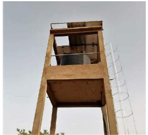
Le toit du château d'eau après le coup de vent
